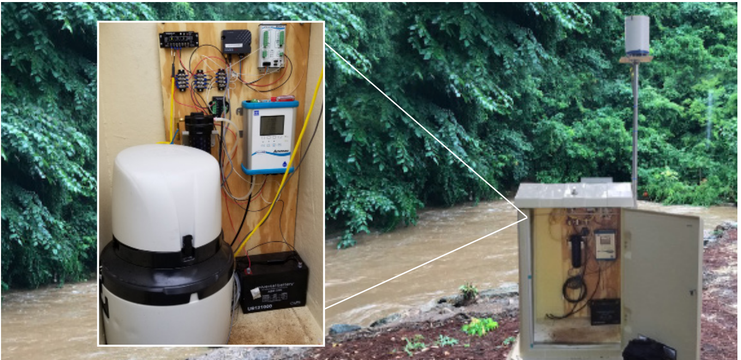
Une station de surveillance en continue de l'eau Xylem a été installée le long de Tanyard Branch. Elle est équipée d'un bulleur Amazon, d'une sonde multiparamètre EXO, d'un enregistreur de données Storm et d'un échantillonneur ProSample.
